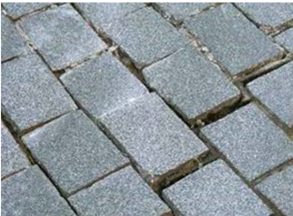
Abb. 9: Verschobener gesägter Natursteinbelag als Folge von fehlender Fugenfüllung und entsprechend hohen Verkehrslasten (Foto Sopro) [7]
