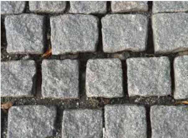
Abb. 6: unregelmäßiges Fugenbild Natursteinpflaster in Splitt gesetzt. Herausgesaugte und herausgespülte Fugenfüllung durch Reinigungsprozess und Regenwasser (Foto Sopro) [7]
