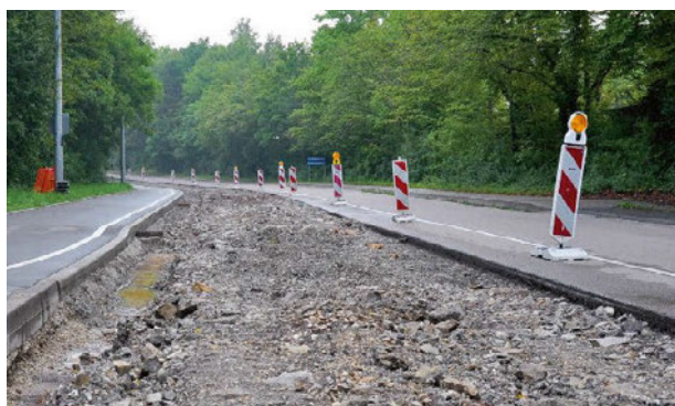
Bild 1: In Stuttgart entschieden sich die Verantwortlichen für eine Straßensanierung mit Verfestigung des bestehenden Materials und anschließendem Überbauen mit Asphalt. Hier die Situation nach dem Asphaltausbau.
