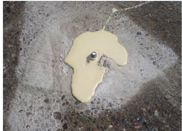
Bild 9: aus dem Bohrloch ausgetretenes Silikatharz
