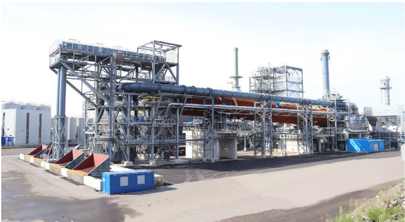
Abbildung 5: Neue Reinigungsanlage (REKO II)
