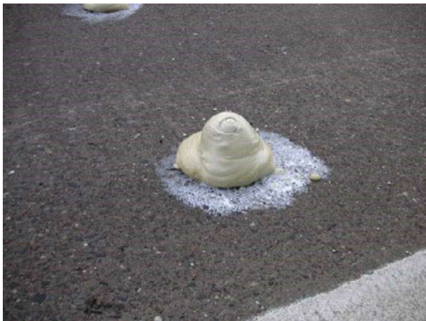
Bild 8: aus dem Bohrloch ausgetretenes Polyurethanharz
