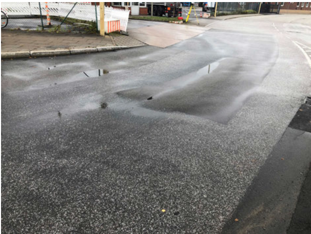
Bild 13: Örtliche Situation vor Beginn der Sanierungsarbeiten – sichtbare Spurrillen, Verdückerungen und Verschiebungen im Flächenbelag (Quelle: BTE stelcon GmbH)
